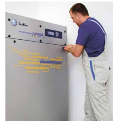
Das Mini-BHKW erzeugt eigenen Strom für die Hausbewohner
