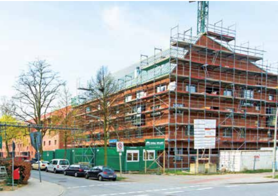
Im nördlichen Bereich des Wilhelmsburger Weltquartiers entstehen öffentlich geförderte Wohnungen im Passivhaus-Standard
